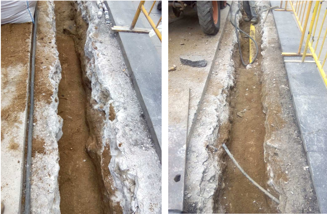
Vista de l'estructura de formigó que protegia les línies de subministrament elèctric existents al tram de la rasa paral·lel al carrer del Pas de l'Ensenyament.
